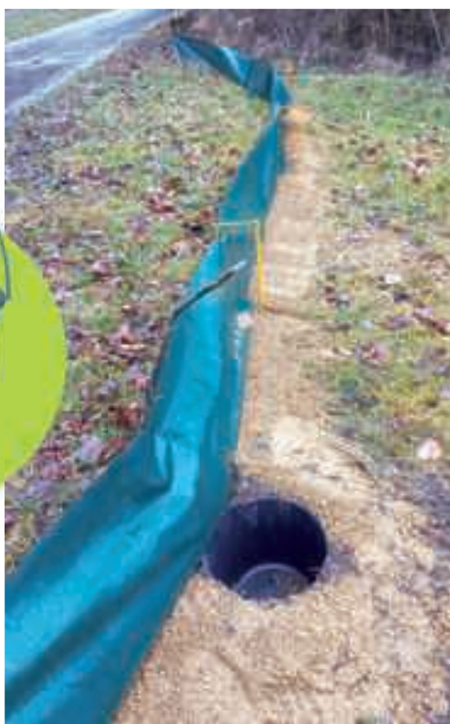
AMPHIBIENZAUN NEBEN KREISSTRASSE MIT RADWEG BEI WORINGEN. DIE TIERE FOLGEN DEM ZAUN UND FALLEN IN EINGEGRABENE EIMER, AUS DENEN SIE DANN GEHOLT UND ÜBER DIE STRASSE GETRAGEN WERDEN. DER ZAUN IST „EINGESANDET“, UM IHN ZUM BODEN DICHT ABZUSCHLIESSEN.
